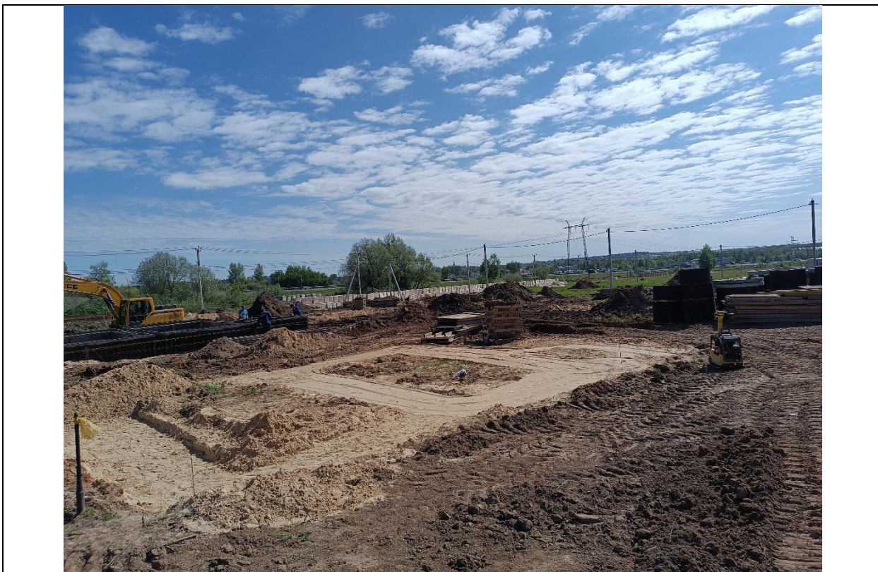
Рисунок А.5. Площадка строительства, вынос осей в натуру, выполнение песчаной подушки под фундаментную ленту
