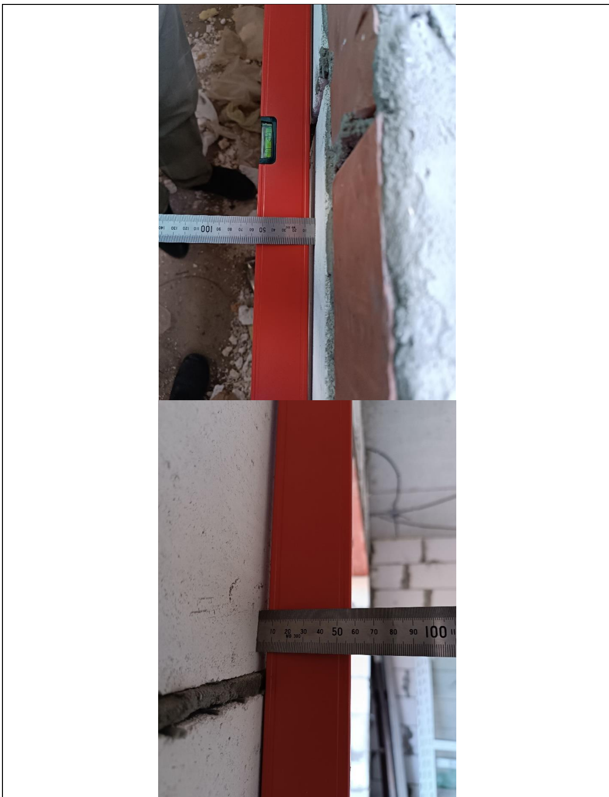
Рисунок А.13. Ровность кладки наружных стен из газосиликатных блоков
