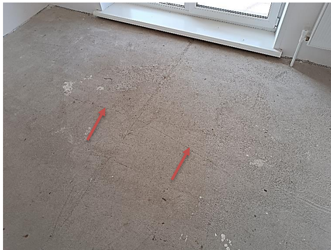
Рисунок 12. Волосьяная трещина (дефект малозначительный)
